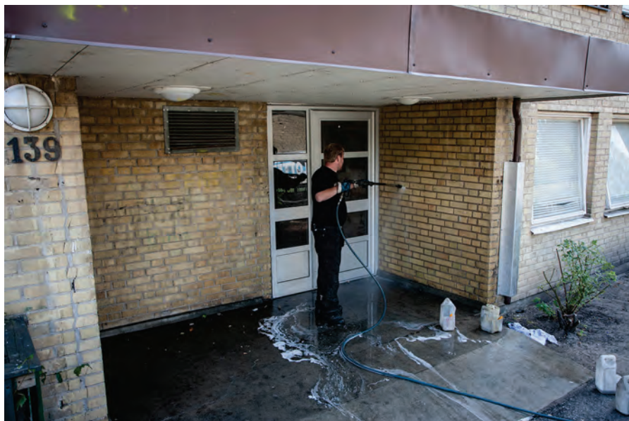
Bild 38. En saneringsfirma med särskild utrustning anlitas för att sanera bort sprejskadegörelse på gatukontorets anläggningar. Fotot visar en anställd på en saneringsfirma som sanerar en entré till ett hyreshus på uppdrag av en privat fastighetsägare.
