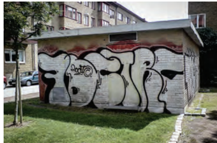
Bild 23. Nätstation. Ett exempel på väggar som ägs av företag som hyr allmän platsmark av kommunen.
