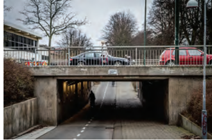
Bild 19. Gång- och cykeltunnlar är exempel på väggar som gatukontoret förvaltar. Det finns ca 300 st. viadukter/gång- och cykeltunnlar i Malmö som gatukontoret förvaltar (intervju: Upphandlaren 2014).
