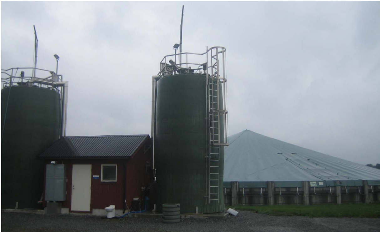
Figur 7. Våtkompostanläggningen i Karby, Norrtälje. På bilden syns de två reaktorerna, manöverhuset, lagringstanken i bakgrunden och framför huset ett en vakuumtoalett, vilket är det som förordas för att maximera TS-halten i inkommande KL-vatten. Foto: H. Jönsson.
