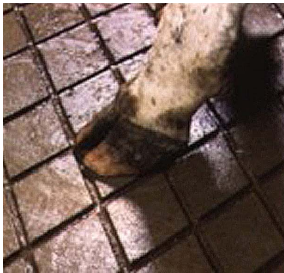
Figur 5. Mönster i form av "diamant" eller "ruter ess". Avståndet mellan mönsterspåren bör vara c/c 80–100 mm, mönsterspåren bör vara ca 10 mm breda respektive minst 6 mm djupa. Spåren kan göras i rät vinkel eller som här i 60/120 graders vinkel.
