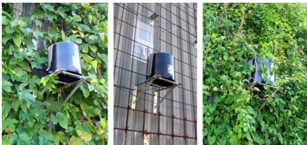
Figur 5. Slagregnsmätare av plexiglas och vippräknare monterade på en plåtvägg med och utan vegetation. Foto: Hans Rosenlund.
