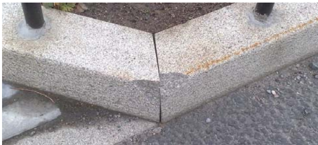
Figur 1. Felaktig fog som ger spjälkning är en vanligt förekommande anmärkning vid slutbesiktning.
