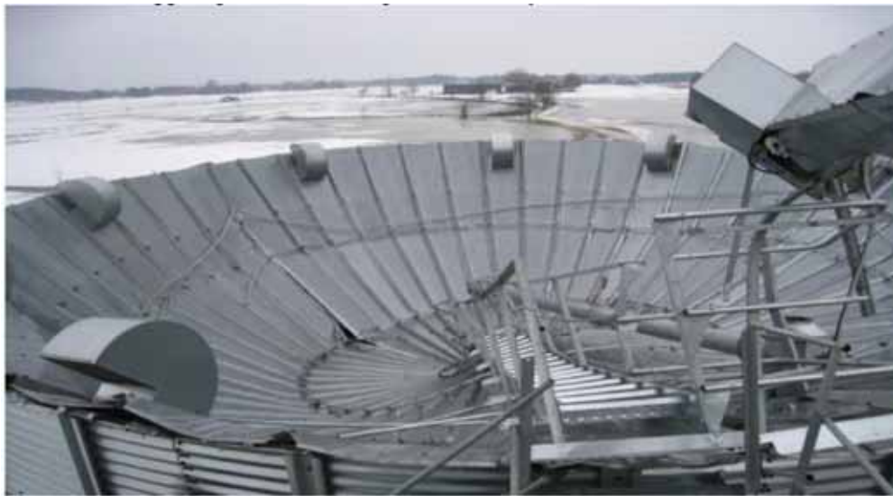
Figur 5.11. Totalkollaps av ett tak till en spannsilo. Foto taget efter det att snön smält bort.
