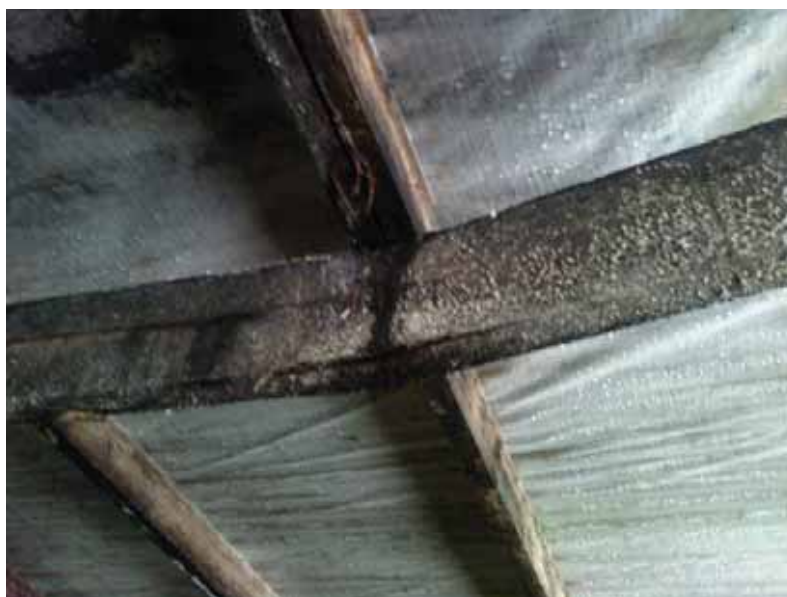
Figur 5.7. Dåligt underhåll av taken eller som i detta fall höga luftfuktigheter p.g.a. felaktig ventilation av djurstallet, resulterar såsmåningom i rötskadat virke med brott som följd om det är en bärande konstruktionsdel.
