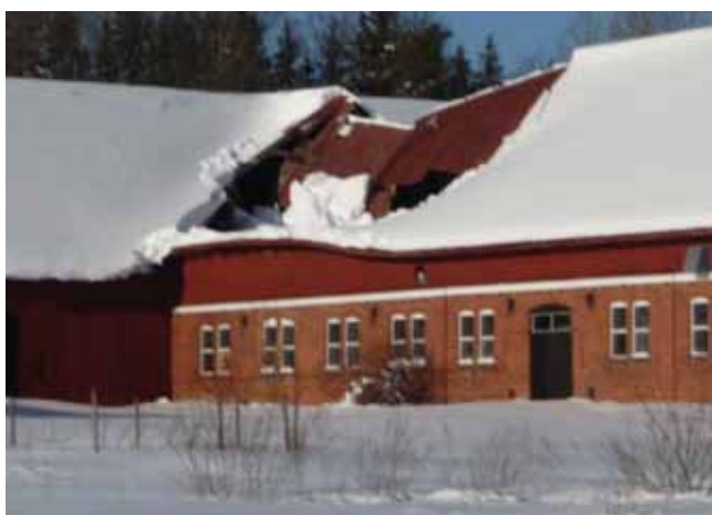
Figur 5.5. Förhöjd snölast i takvinkeln mellan två byggnader har resulterat i takskada.
