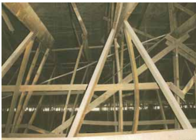
Figur 5.4. Skadad takkonstruktion av spikplåtsförbundna träfackverkstakstolar. Taket skadat p.g.a. otillräcklig stagning med vippning och knäckta diagonaler som följd.
