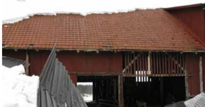
Figur 5.6. Snöras från byggnad med 45° taklutning ner på ett sammanbyggt skärmtak som rasade.
