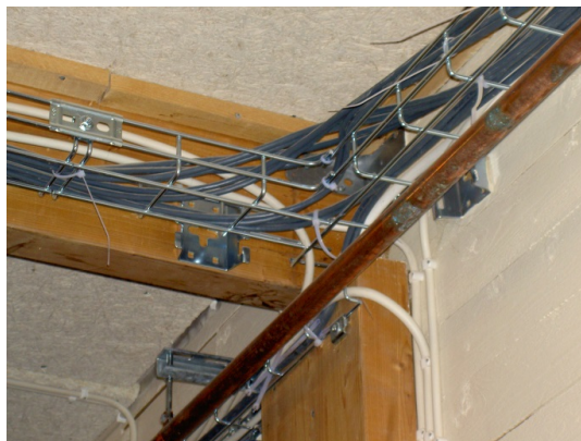
Exempel på kabelkorg.
