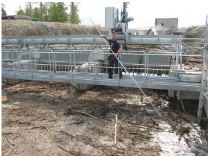
Figur 17. Som komplement till rensroboten behövs manuell hjälp med rensning av fisktrappans intagsgallret vilket är tidskrävande då ledarmen också tidvis leder in stora mängder skräp och drivgods till fisktrappan.
