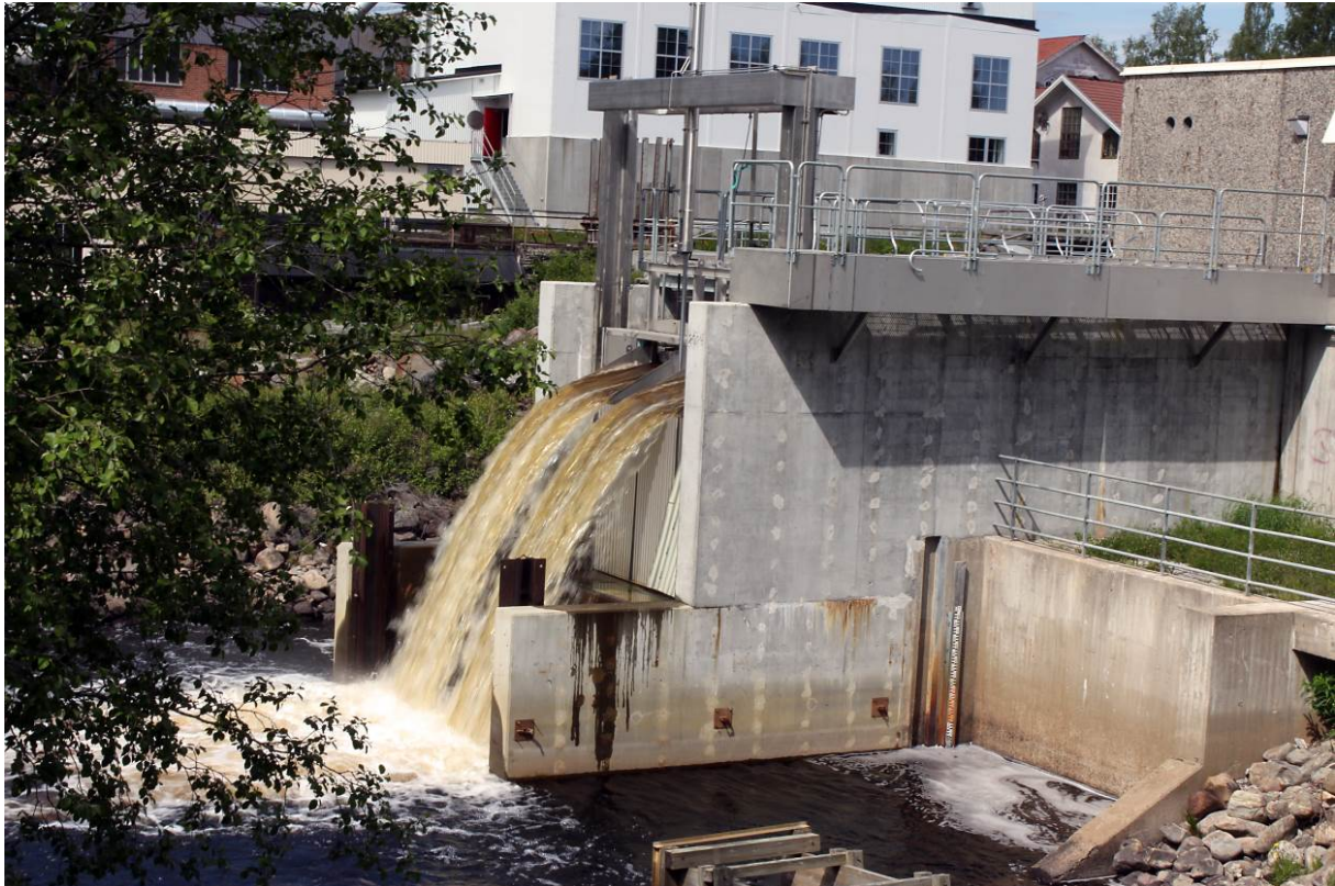
Figur 2. Vattenkraftsanläggningen som bygger på en design som utarbetats inom projektet Miljöaccepterad småskalig vattenkraft möjliggör för ytligt simmande fiskar att passera över intaget till turbinen vidare nedströms i anläggningen med möjlighet att passera nedströms via spilluckorna. Anläggningen på bilden har installerats vid Bruksfors i Rickleån och ägs av Skellefteå Kraft. Foto Evalena Karlsson.
