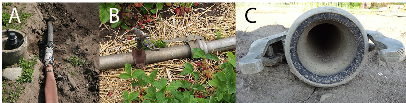
Figur 3. Rörskopplingar. Koppling från nedgrävt stamledningsnät till flexibel slang (A); galvaniserade bevattningsrör med snabbkoppling (B); närbild på insidan av bevattningsröret vid kopplingsstället (C). (Foto: A och C: Beatrix Alsanius; B: Charlotta Löfström)
