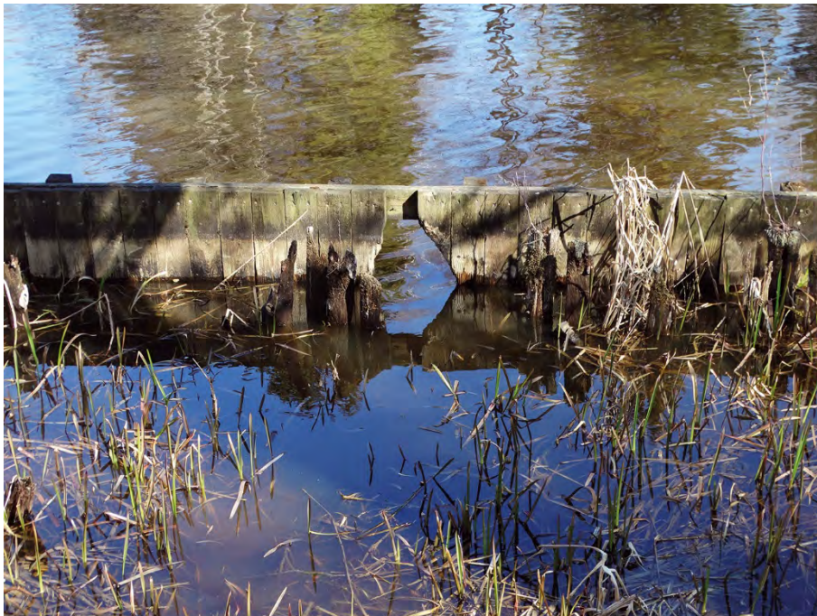
Figur 53. Här har dåligt underhåll av erosionsskyddet lyckligtvis lett till att det bildas möjligheter för djur att ta sig mellan stranden och den öppna sjön. Foto Erik Degerman.
