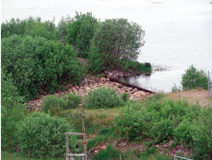
Figur 40. Överfallsdämmet vid Dravens utlopp ger möjligheter att reglera vattenståndet och hindrar samtidigt uppvandring av fisk. Foto: Erik Degerman.
