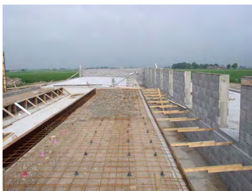
Figur 4. Ekologisk slaktgrisproduktion. Sidokanter till gödselrännor och väggar i stallet byggs upp med skalblock av betong. Blocken är ihåliga och armeras med armeringsjärn och fylls med betong.
