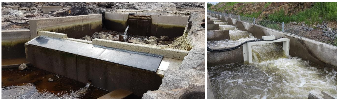
Pit-tag antenn Baggböleforsen och fisktrappan
