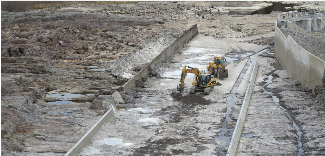
Arbete med utskov b, anläggande av ledmurar och igengjutning av håligheter. Foto: Åke Forssén
