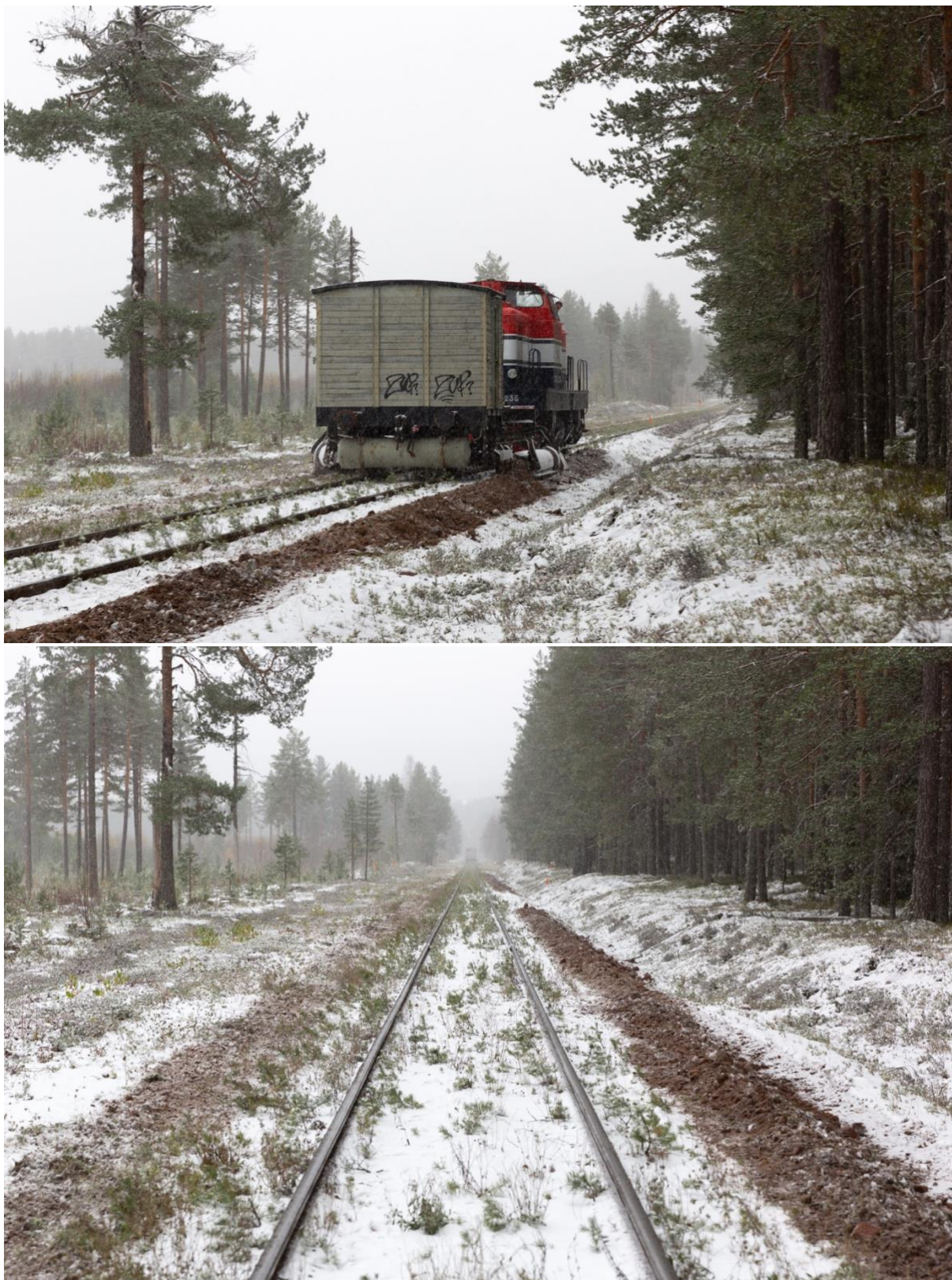
Figur 20. Ojämn effekt av ballastplogen i Oxberg, en effekt av slitna plogar.
