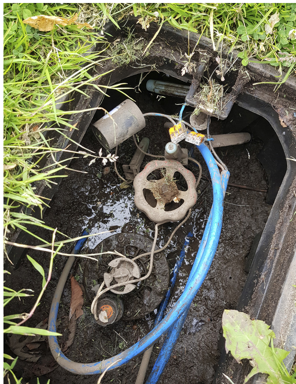
Installation för fjärrstyrning av ventil till bevattningsanläggning. Foto: Anders Kristoffersson
