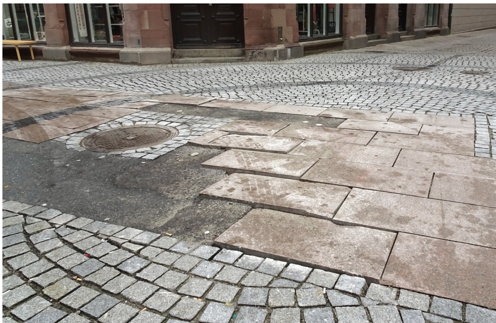
Bild 10. Innerstadsgata där håll efter håll ersätts med asfalt som provisoriska symtomlösningar. Foto: Kurt Johansson.
