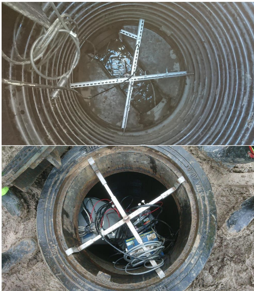
Figur 12. Installation av turbiditetssensor i dagvattenbrunn inom Life IP Rich Waters projektet i Västerås. Ovan: Sensorn installerades lodrätt i mitten av dagvattenflödet med sensorn riktad nedströms för att skydda optiken mot flytande föremål. Nedan: Komplet installation i dagvattenbrunn med datalogger, batteri och styrenhet för en parallellt installerad flödesmätare.
