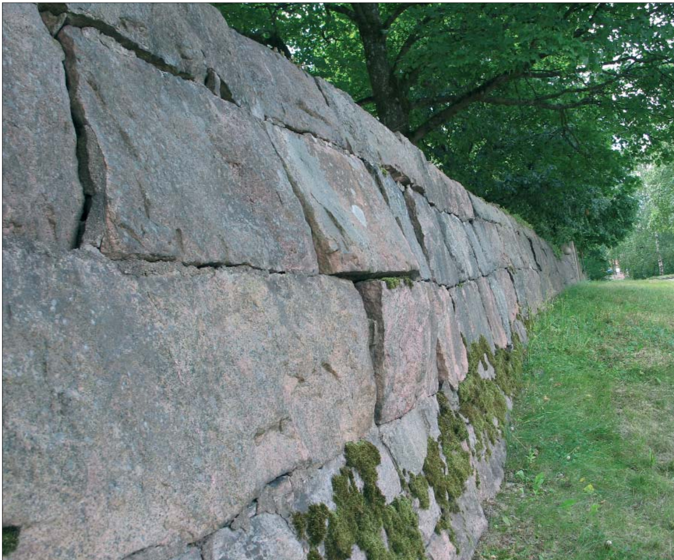
Mur av huggen sten. Sättningar i marken på grund av trädrötter och vattenrörelser i marken har lett till att stenarna rubbats och muren buktar. Foto: Catharina Svala
