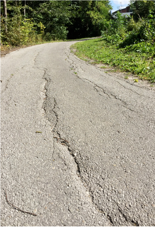
Sprickor och åsar i hårdgjorda ytor försvårar för cyklister och gående och är problematiska vid renhållning och snöröjning.
