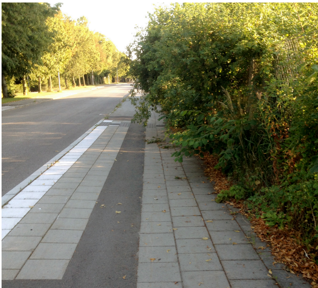
Rosenbuskar som breder ut sig gör att gång- och cykelvägen blir svårframkomlig och ger skymd sikt.
