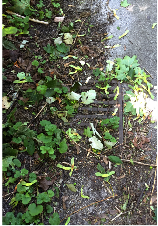
Växtrester från den omgivande miljön och eftersatt sopning av gatan har gett en igensatt brunn en ny funktion som växtbädd.
