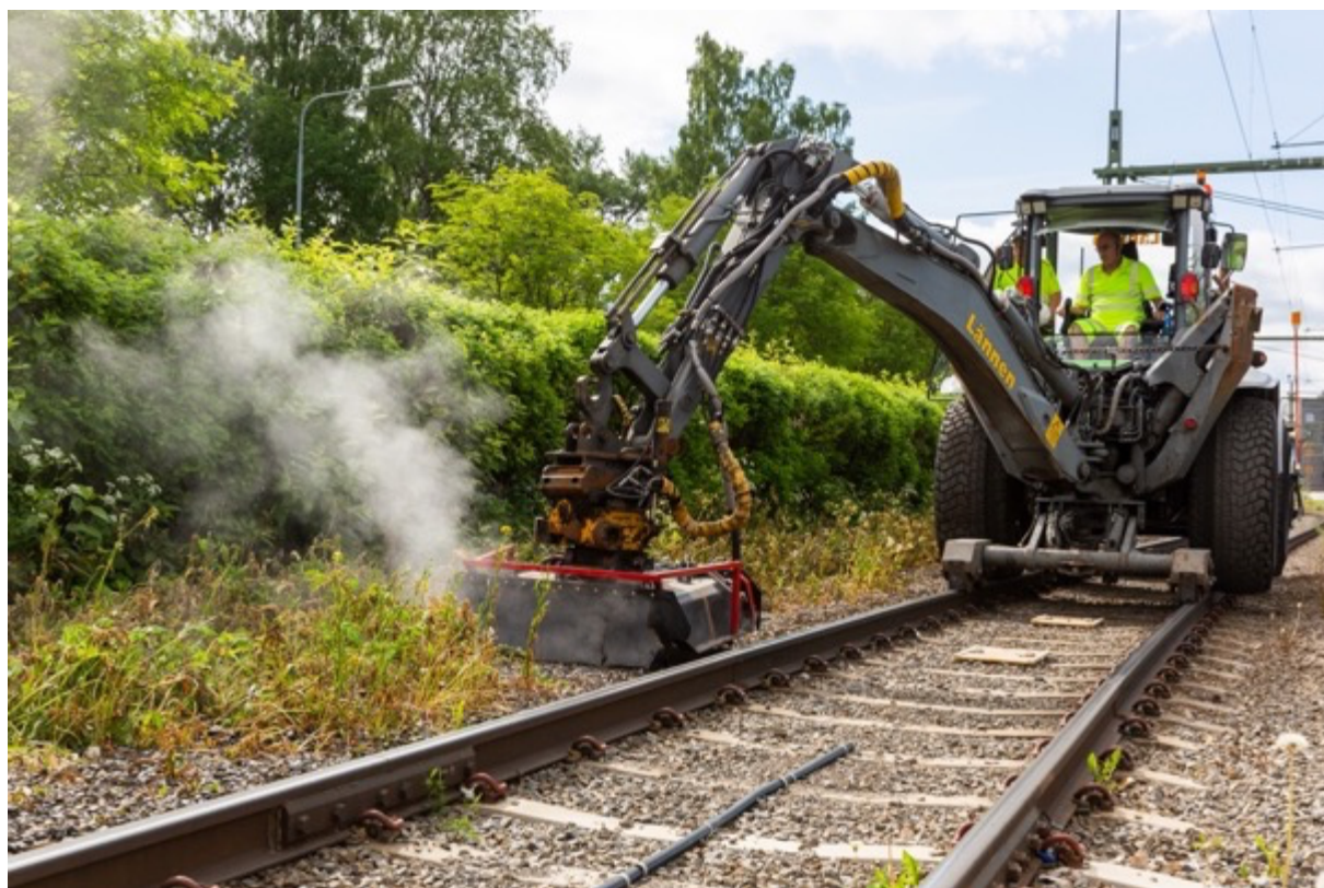
Figur 42. Ramviks Entreprenads utrustning för hetvattenbekämpning. Vattnet finns i en tank på baksidan av traktorgrävaren och hettas upp med hjälp av ett dieselaggregat. Det upphettade vattnet pumpas genom en isolerad slang ut till en rad sprutmunstycken som sitter monterade under en huv på traktorgrävarens arm. Ungefär 1 m breda stråk bekämpas åt gången.
