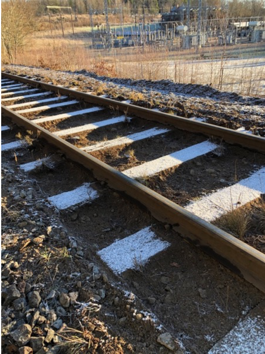
Figur 8. Vegetationsläget efter ballastplogning km 42+400 den 22 november 2021
