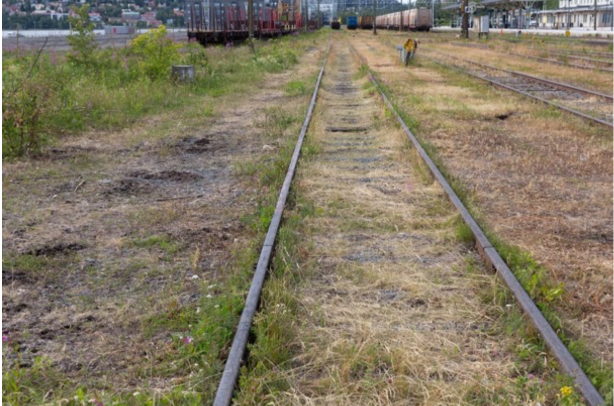
Figur 49. Försökssträcka 2 med tydliga hjulspår mitt i spåret.
