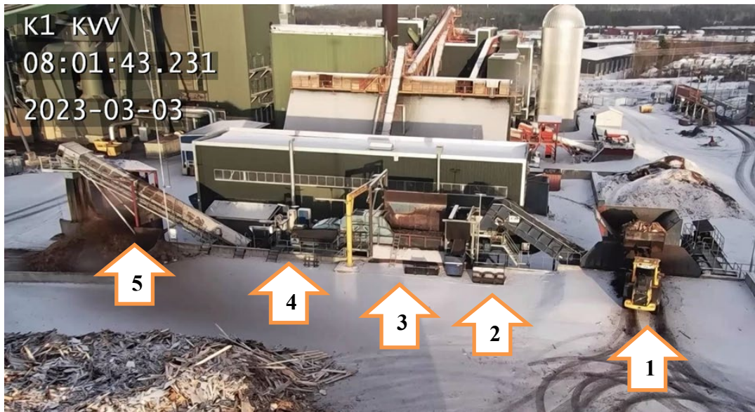
Figur 44. Bilden visar delar av bränslehanteringen på Jämtkrafts anläggning i Östersund. Vid pil 1 lastar en hjullastare returträ i en förkross. Materialet passerar därefter en magnetisk metallavskiljare (pil 2) och vidare in i en slutkross (pil 3). Efter slutkrossning passerar ännu en magnetisk metallavskiljare (pil 4) och det färdigbearbetade bränslet går vidare in mot pannan (pil 5). Foto: Jämtkraft.
