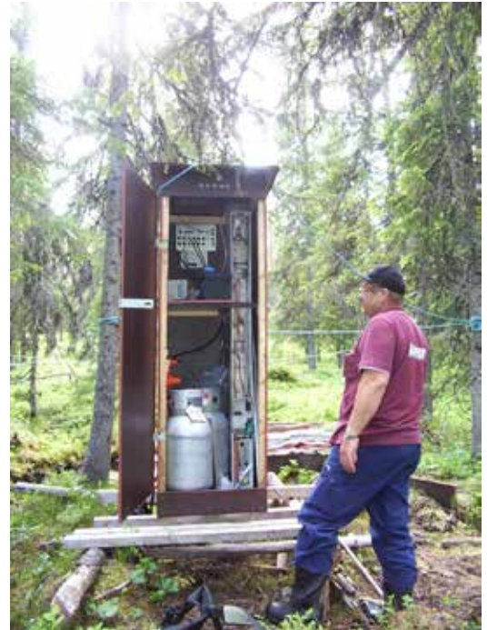
Tommy Jansson inspekterar installationer vid avbörningsstationen i Gammtratten 1998. Foto Hans Kvarnäs.
