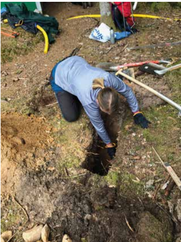
Pernilla Rönnback lägger sista spadtaget i ny grop för markttemperatur i Aneboda, juni 2019. Foto Mikael Östlund.
