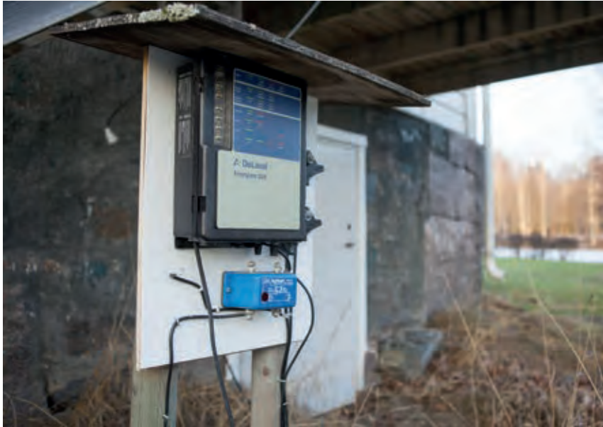
Bild 89. Elaggregat och åskskydd.
