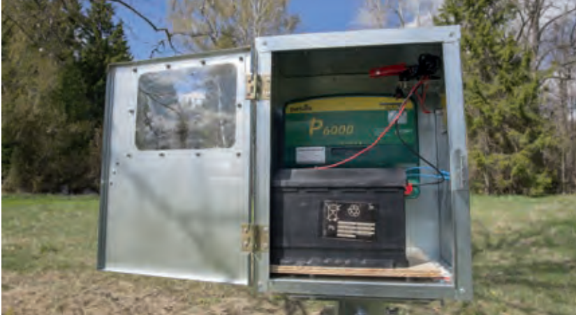
Bild 30. Plåtskåp för montering av batteriaggregat.
