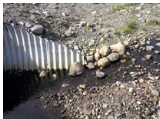
Figur 7. Vid kanten av denna nedgrävda heltrumma har högvatten eroderat. Det är mycket viktigt att erosionssäkra genom att lägga större sten (eventuellt krossten) vid kanten, alternativt gjuta en betongkrage vid sådana här ställen. Gjuts en betongkrage minskar också risken att skräp och grenar fastar uppströms trumman, men i gengäld ökar vattenhastigheten i trumman något. Öre älvs övre delar, Västerbotten.
