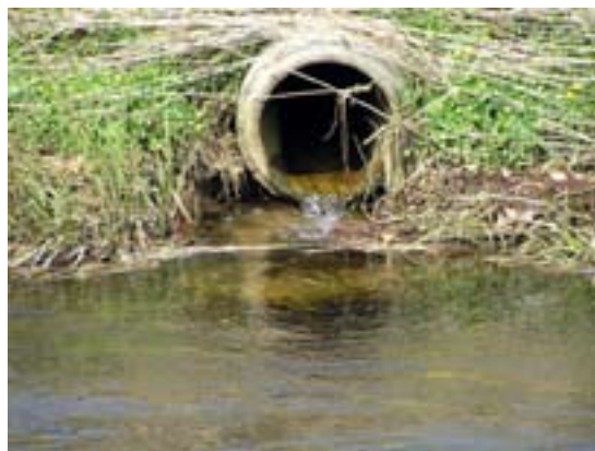
Figur 19. Dränering av jordbruksmark rakt ut i ytvatten innebär en stor närsalttillförsel. Rör som är så här lågt placerade tenderar att ge dålig markavvattnings vid höglöden.
