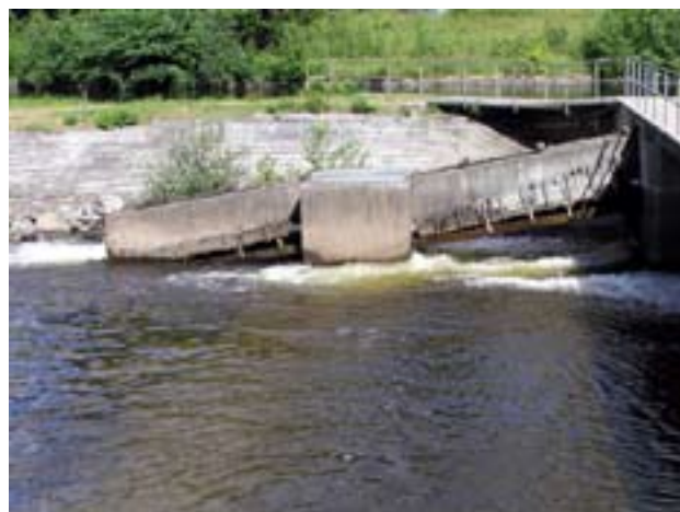
Figur 23. En fiskväg i form av en denilrännan vid Aspens utlopp i Säveån, Västra Götalands län. Observera hur extra lockvatten från Aspendammen styrs mot fiskvägen. Utanpå denilrännan sitter en älledare av trä fäst. Älen har inte samma krav på hög vattenström som laxfisk, varför älledarens placering är tveksam. Plats: 640865-128450, karta 7 B SO.
