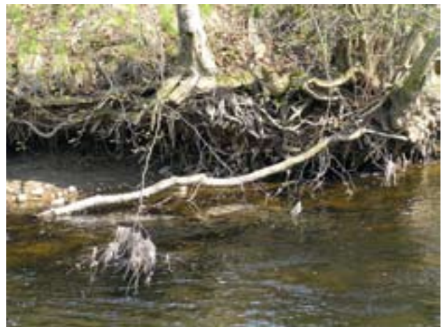
Figur 1. Träd som växer fram till strandbrinken stabiliserar den och skapar vid högre vattenstånd utmärkta platser för fisk och smådjur. Än i bilden håller dock på att underminera strandbrinken, vilket indikerar att sträckan är utsatt för erosion. Rötter och stränder visar spår efter olika vattennivåer. Bråån, Skåne, vid lågvatten.
