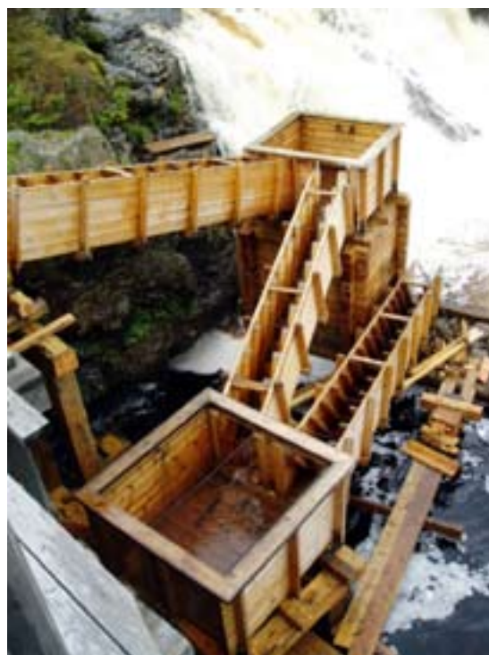
Figur 20. Denilränna vid Hovermo, Jämtland. Eftersom fallet är naturligt och svärpasserat ansågs denna ränna vara ett lämpligt alternativ för att i huvudsak endast få vandrande öring. Rännan är helt byggd i kärnfuru från området. Den nedersta sektionen kan lyftas ut inför vintern. Fallhöjd 4,4 m och längd 22 m på rännorna, exklusive vilobassänger. Detta ger en lutning på 20 %. Kostnad ca 800 000 kr, dvs. ca 180 000 kr per fallhöjdsmeter. Öring passerar trappan. Konstruktör & Foto: Erik Sjölander, Fisk- och Vattenvård AB. Plats: 697560-142652, karta 18 E NO.
