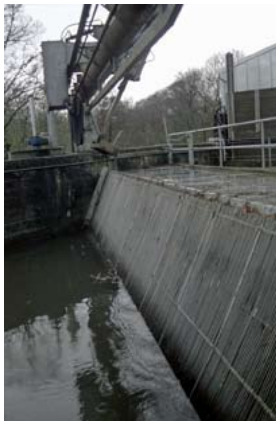
Figur 24. Fingrindar vid Vestberge kraftverk i Gudenå, Danmark. Grindarna rensas med robot, vilken syns på fotot. Konstruktionen med fingrinden tvärs vattendraget och så nära intaget till turbinerna medför stor risk att fiskar fastnar mot gallret. Denna typ av fingrindar används ofta främst för att hindra skräp från att komma ned i turbinerna. Speciellt Francis-turbiner är känsliga för skräp.
