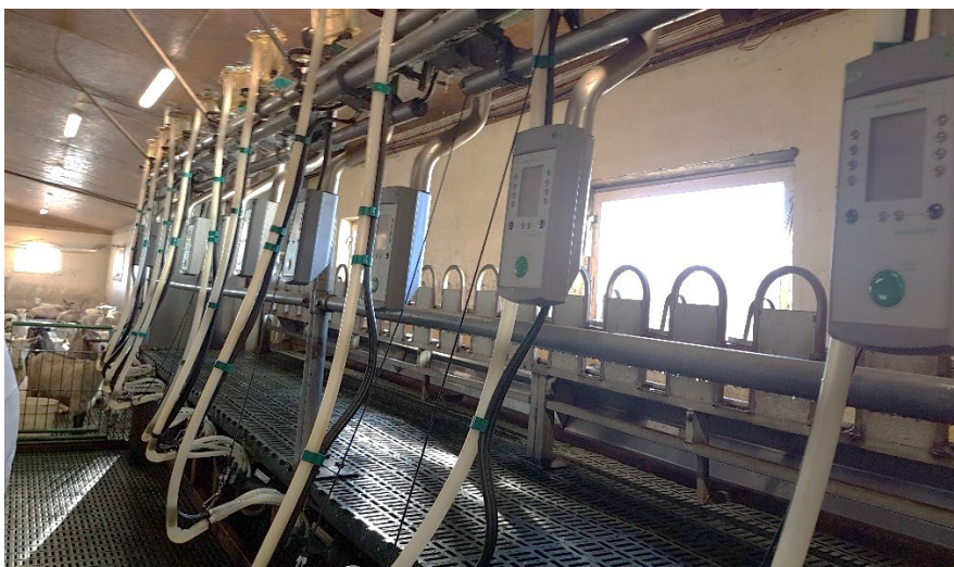
Figur 9.10. Parallellstall med mjölkning bakifrån. Mjölkbord med göseldrainerande golv.
