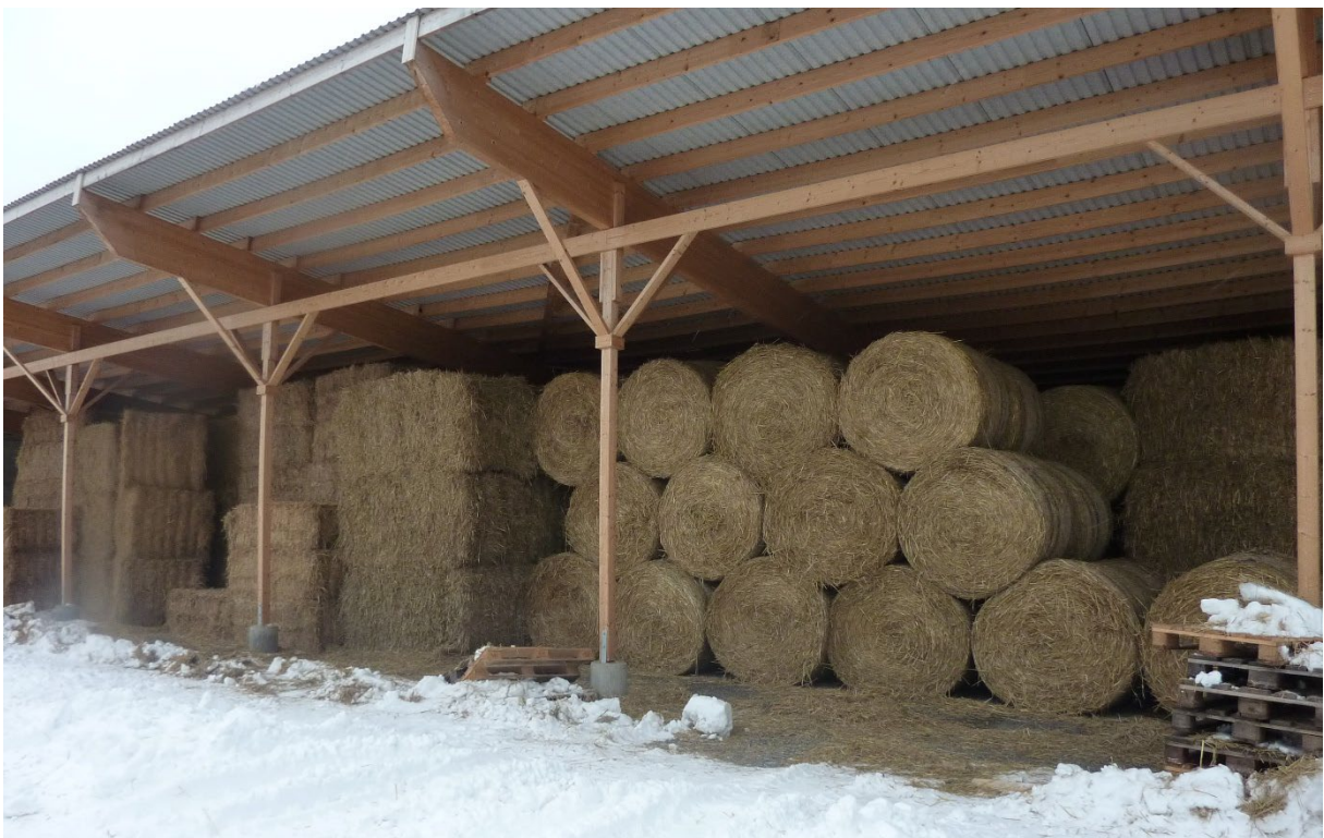
Figur 13.2. Exempel på en byggnad för halmlagring med överkragade tvåstödsbalkar. Foto: Madeleine Magnusson.
