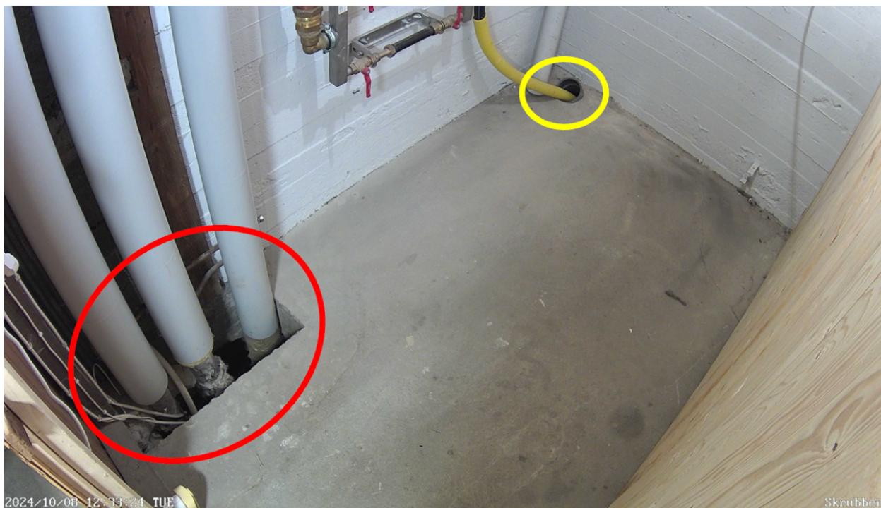
Figur 4 visar "skrubben", den gula cirkeln visar var råttorna kommer in i huset. Den röda cirkeln visar var råttorna tar sig ner i installationsschaktet som löper under hela huset.
