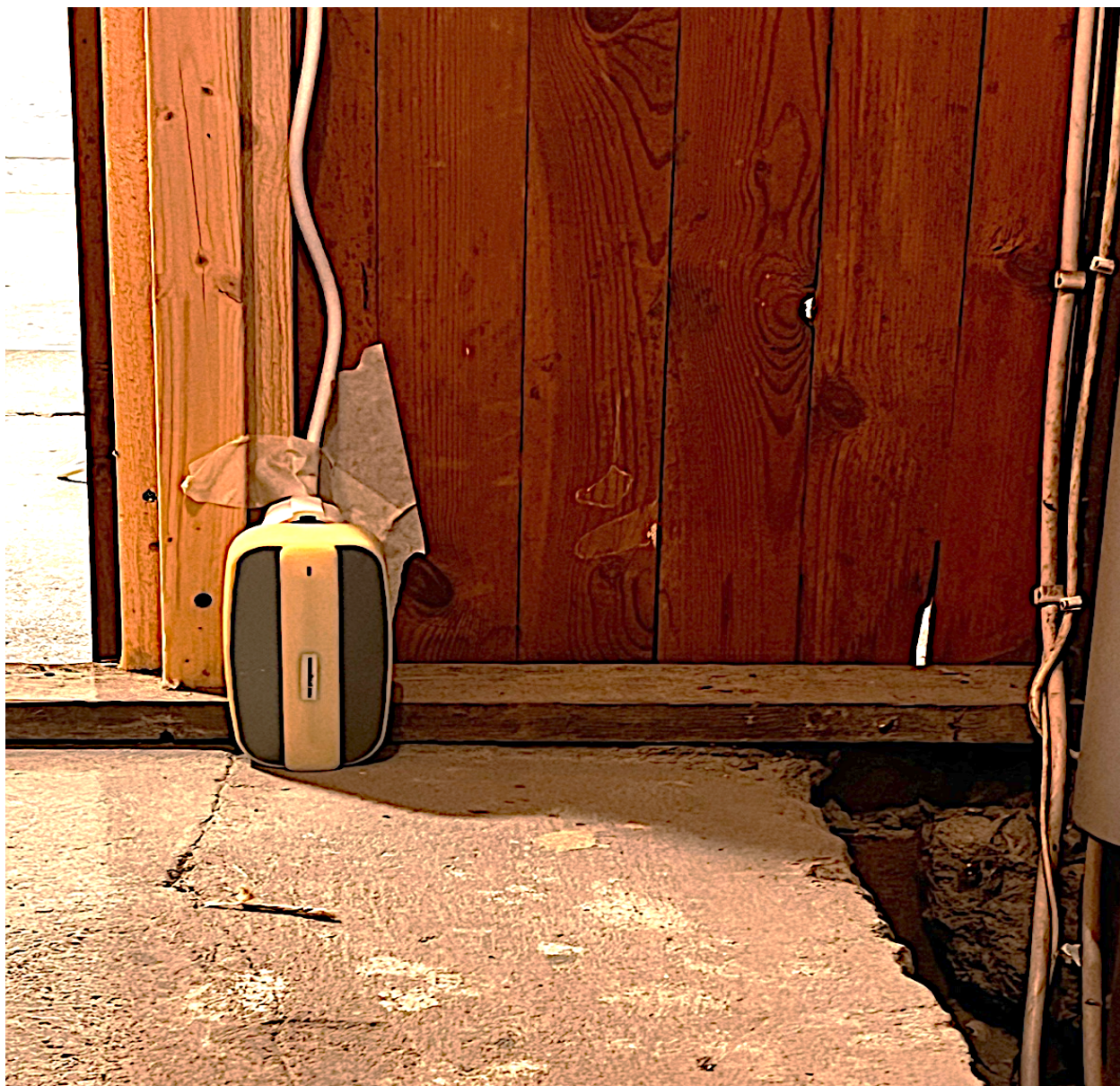
Figur 17 visar skrämmans position precis bredvid installationsschaktet som ses till höger i bild. Skrämman är satt i öronhöjd för en råtta.
