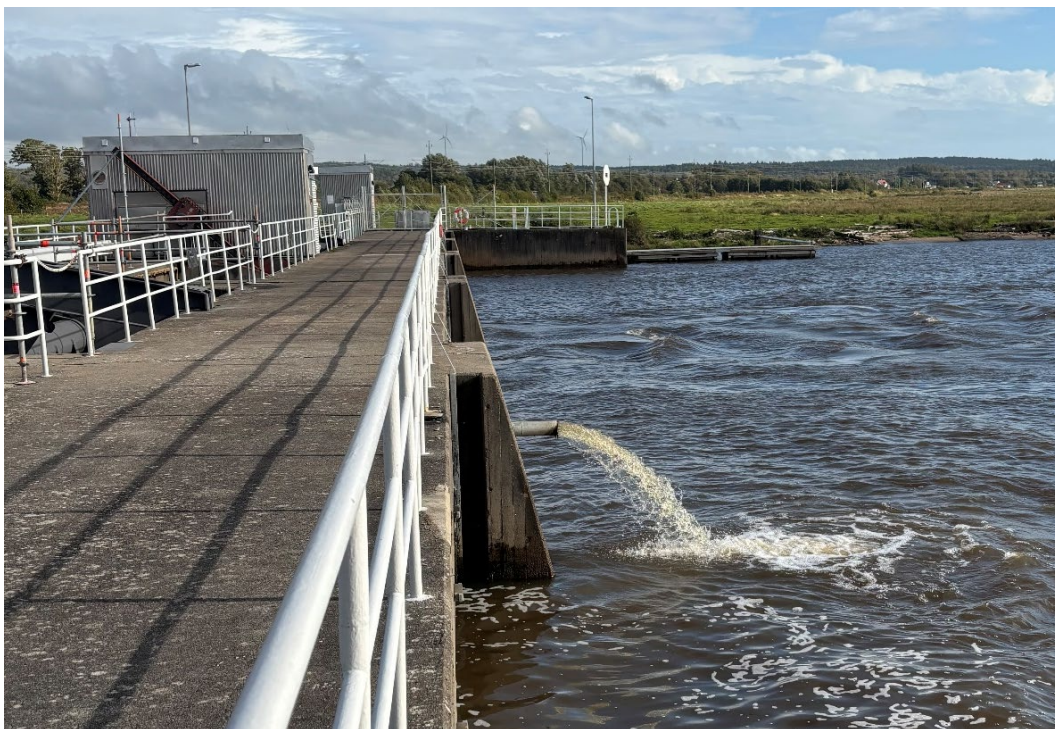
Bild 3. Vattenpump som tar vatten från insidan av dammen och pumpar ut på utsidan nära ledare 3/Elfi. Foto: Madeleine Karlsson
