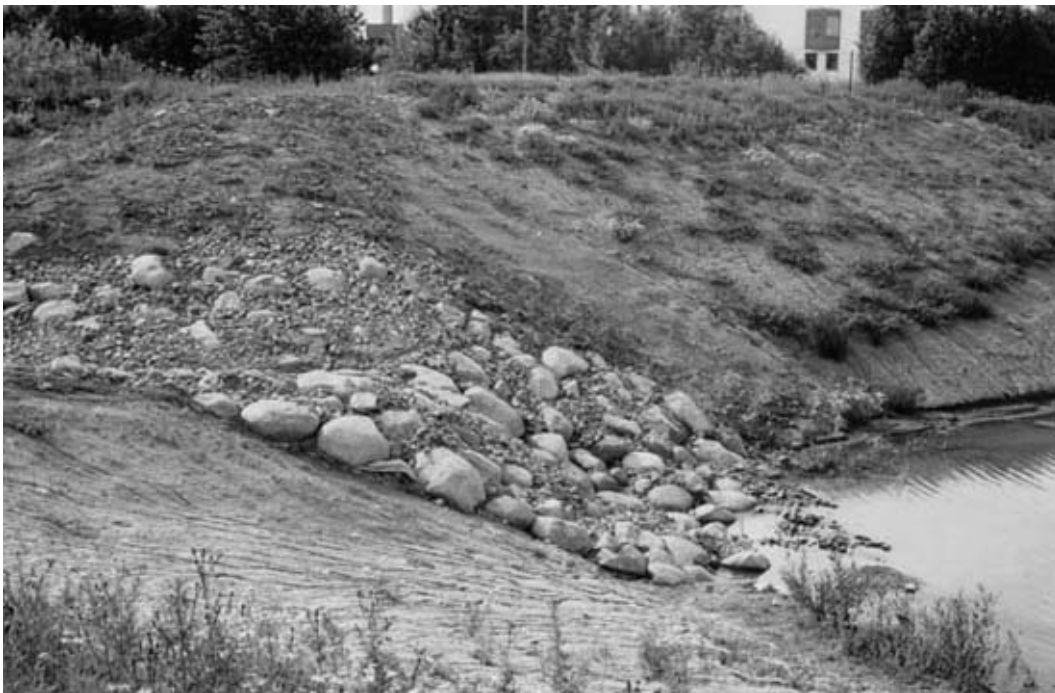
Figur 18. Ett exempel på ett till synes väl dimensionerat överfall. Bild tagen av Jesper Persson.
