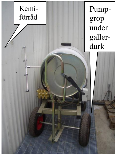
Figur 7. Spruta parkerad på gallerdurk, över en pumpgrop. Kemi-lieferförrådet placeras bredvid (foto: Klara Löfkvist).
