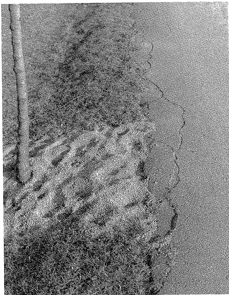
Bild 2 Dålig kantstabilitet. Asfaltytan behöver ordentligt kantstöd.
