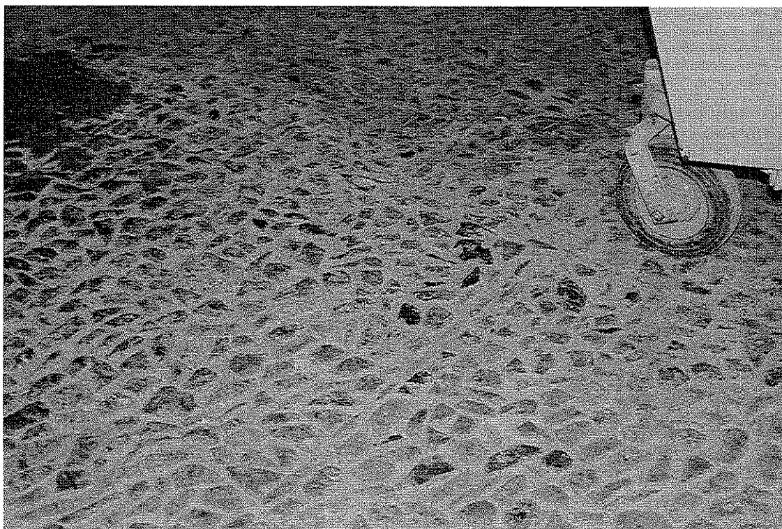
Figur 18. Betonggolv med 5-10 cm stora stenar i ytan.
