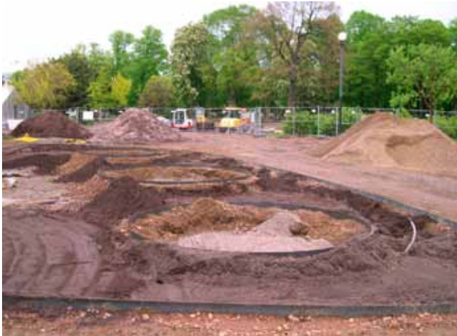
Figur 2. Byggnadsminnet Trädgårdsföreningens park i Göteborg. Omfattande markarbeten framför Palmhuset inför utställningen Göteborgs Lustgårdar 2008. Kortenstäl, fiberduk och dräneringslangar – långt från 1800-talets och parkens ursprungliga trädgårdshantverk. (Foto: Kjell Lundquist, 20 maj 2007)
