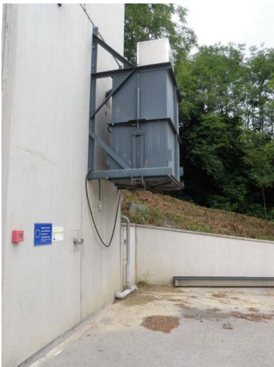
Figur 12. Utvändigt askbehållare för enkel tömning i lastbil. Från värmecentral i Österrike.
