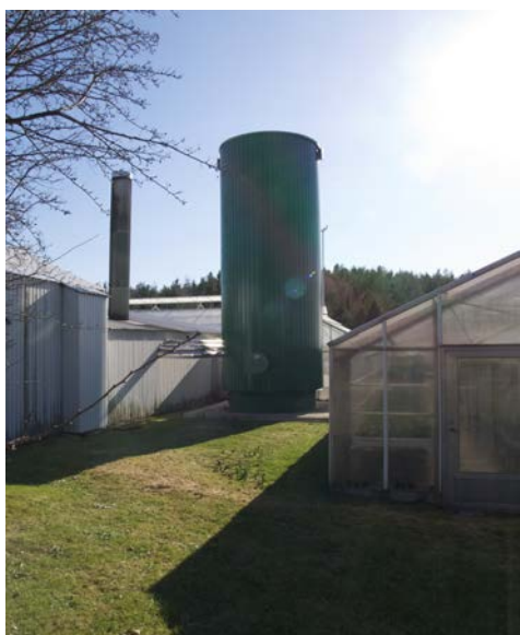
Figur 14. Bufferttank hos ett prydnadsväxtföretag med värmepump kopplad till ytjordvärme.
