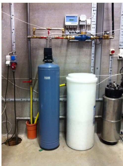
Figur 15. System för avhärddning av värmesystemets vatten för att motverka bildning av pannsten. Anläggningen på bilden är till en anläggning med en vattenvolym på 120 m 3 vatten inklusive tank och kulvert.
