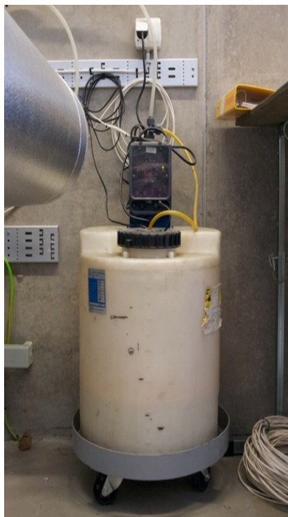
Figur 16. Utrustning för pH-höjning av hetvattnet för att motverka rost och pannsten. Anläggningen på bilden är till en anläggning med en vattenvolym på 120 m 3 vatten inklusive tank och kulvert.
