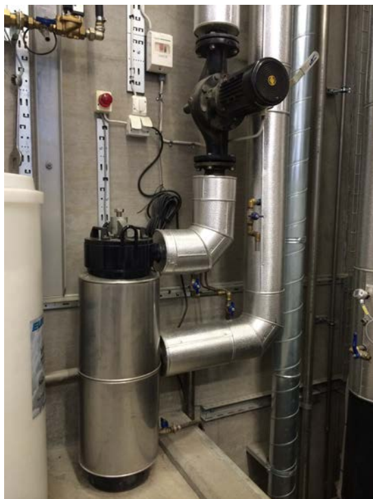
Figur 17. Filtrering av systemvattnet. På golvet står filterbehållaren och ovanför syns pumpen som pumpar ett delflöde av systemvattnet genom filtret. Det här filtret används till ett system med ca 120 m 3 vatten.
