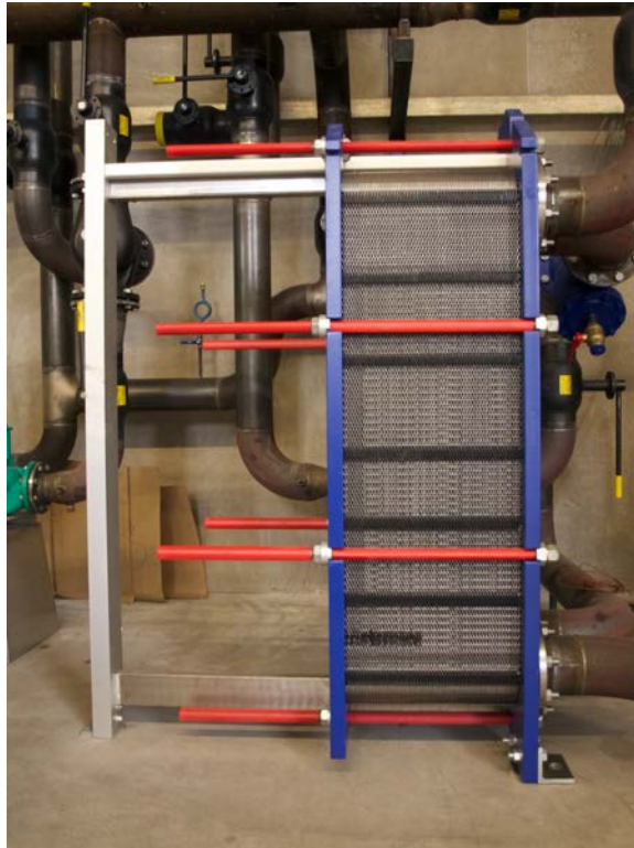
Figur 5. Värmeväxlare som separerar pannkretsen från växthusens värmekrets. Höjden på växlaren på bilden är ca 1,5 m och den klarar effekten 3 MW. Värmeväxlaren på bilden var oisolerad när fotot togs och isolerades efteråt.
