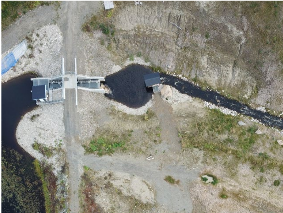
Figur 19. Omlöp som är utformat som en hybrid mellan slitsränna och en naturlig stigränna. De inledande 7 slitsarna möjliggör en jämn flödesregim i omlöpet trots varierande övervattenyta. Foto: Mattias Olsson, Länsstyrelsen Västernorrlands län.
