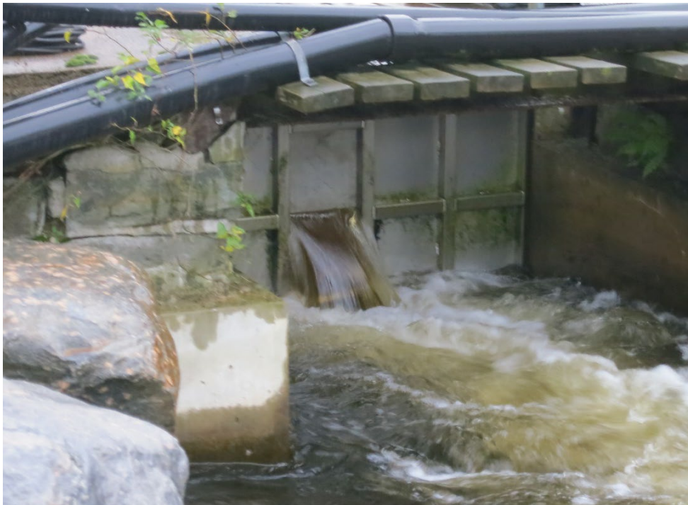
Figur 18. En lucka i omlöp som används vid reglering leder till höga vattenhastigheter som kan vara svåra att passera för svagsimmande arter. Bilden är tagen från nedströmssidan. Foto: Fiskevårdsteknik.
