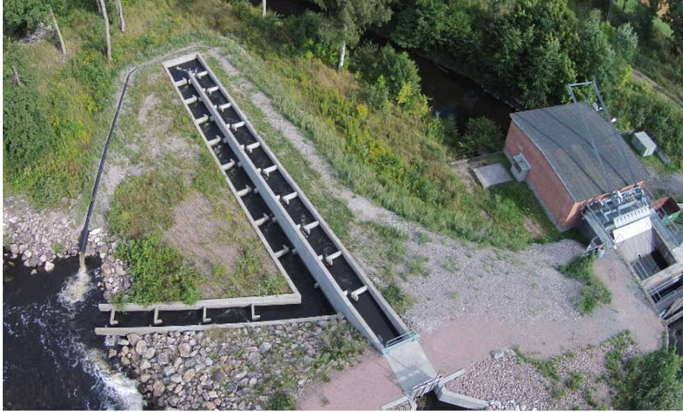
Figur 58. Passagelösningar för upp- och nedströmsvandrande fisk. Flykträna i form av en tub som delvis går under marken. På bilden syns även alfa-gallret som leder fisken mot flyktöppningarna och vidare in i tuben. Foto: Johan Lind, Mälarenergi.
