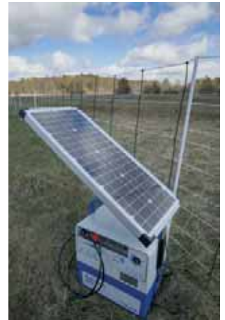
Bild 31. Batteriaggregat och solpanel används främst vid akutstängslelnät.
