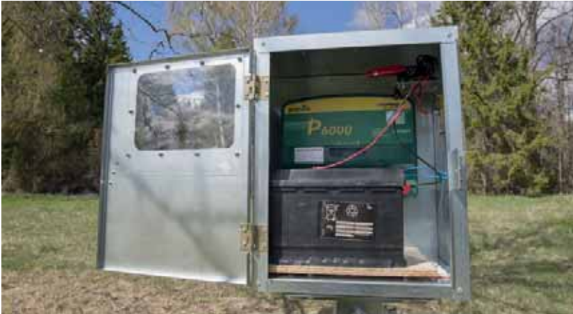
Bild 30. Plåtskåp för montering av batteriaggregat.
