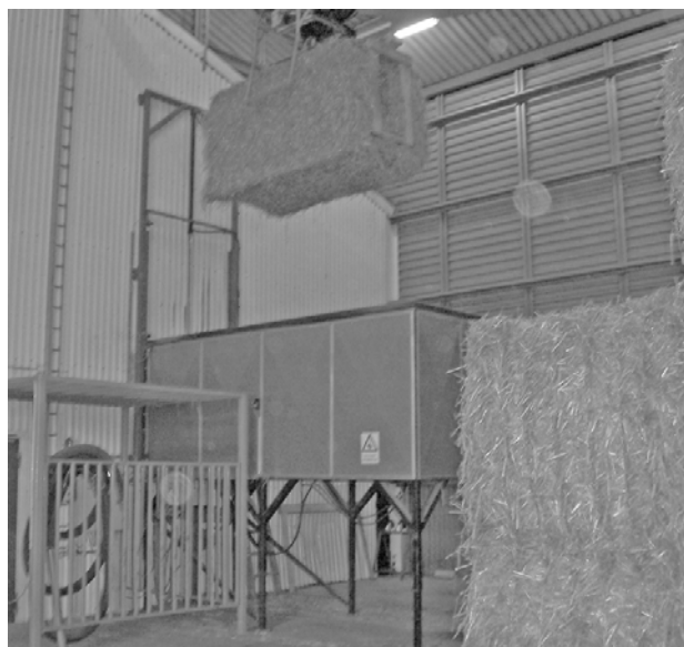
Bild A8. Automatisk travers, Skurups värmeverk.
